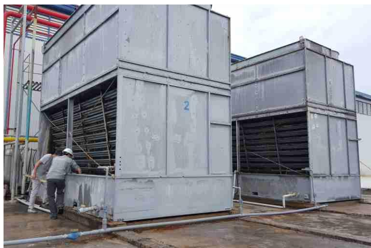
Dàn ngưng tụ bay hơi (evaporative condenser)
