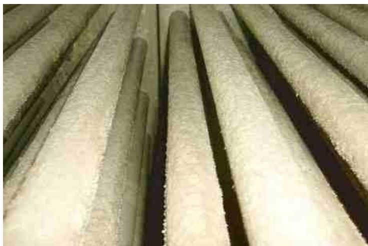
Cáu cặn tại thời điểm lắp đặt.
