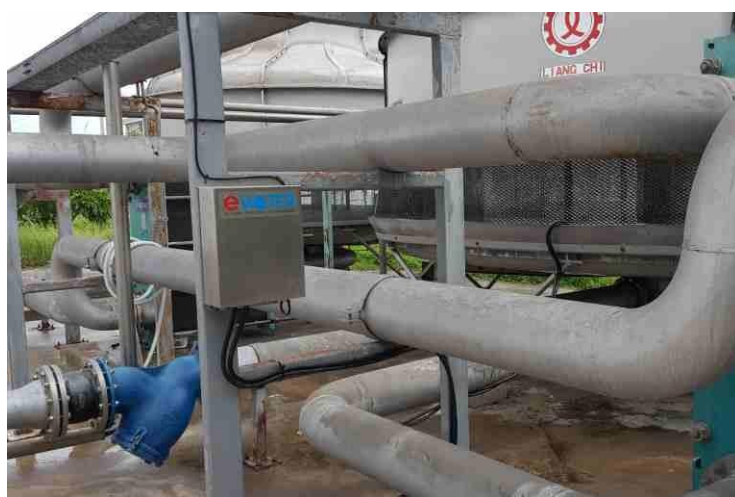
Tủ điện điều khiển
