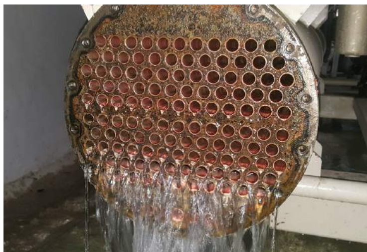
Condenser sạch hơn sau khi lắp Ewater
