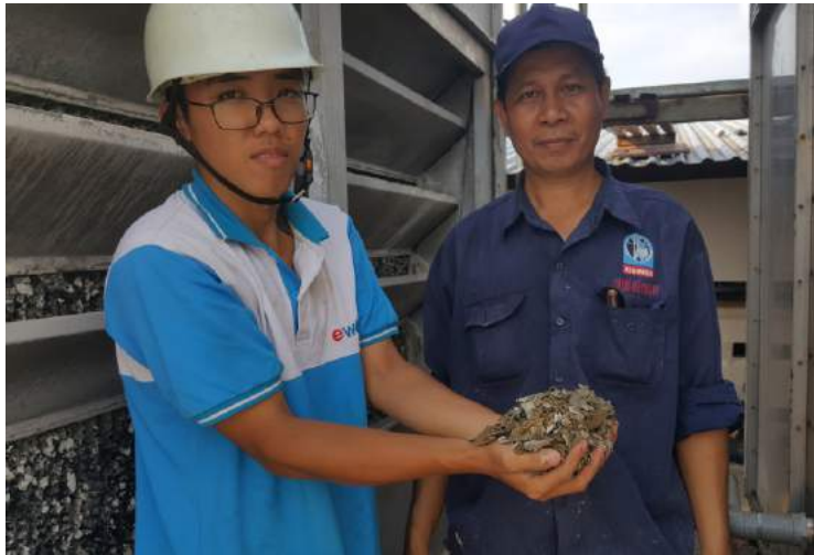
Cáu cặn lấy từ condenser của chiller
