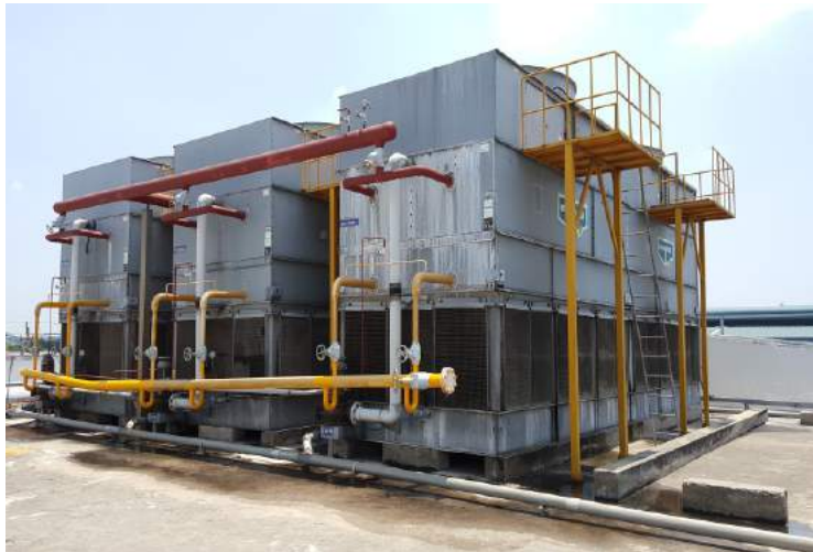
Dàn ngưng tụ bay hơi (evaporative condenser)
