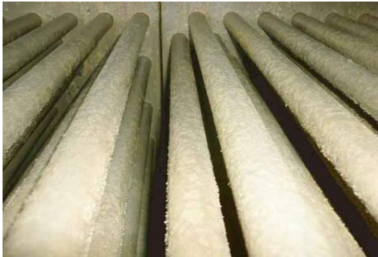
Cặn cặn tại thời điểm lắp đặt.
