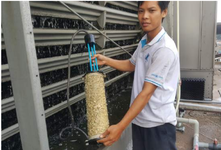
Thu được 3kg cặn cặn sau 1 tháng lắp Ewater
